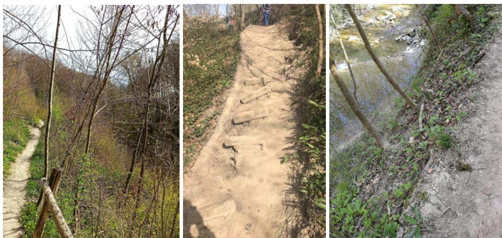
Le chemin nécessite des travaux de sécurisation à plusieurs endroits
